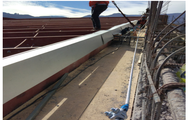
Instalación de forros en canal aguas de lluvia, eje U2/1a-19a, templo mayor.
