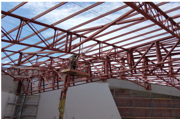
Montaje de ángulos de anclajes para estructura metálica secundaria, cielo templo mayor.
