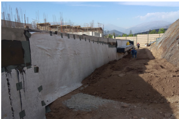
Relleno compactado (sin control), detrás de muro eje 17/Q-Y1, piso 1.
