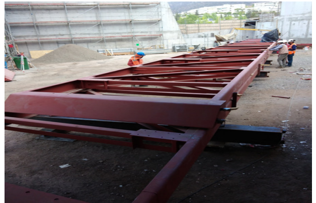
Proceso de nivelación y soldadura de tramos de cerchas ER01-ER02, viga A1.
